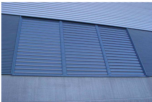
Czerpnia ścienna w Kraftwerk Bitterfeld
