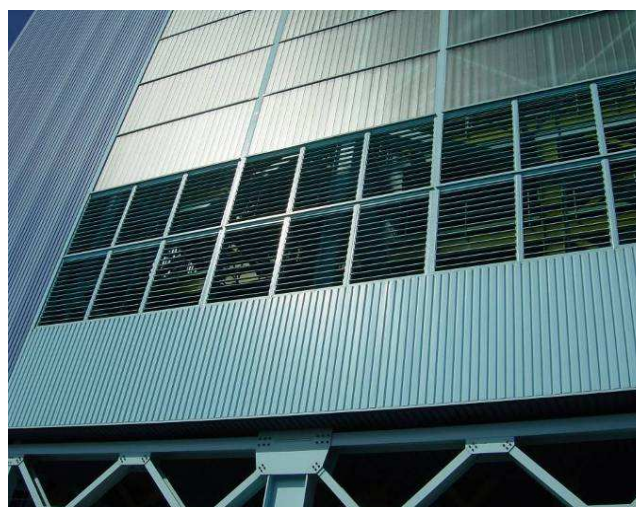
Czerpnia ścienna w Thyssen Krupp – Bonazinc 3000
