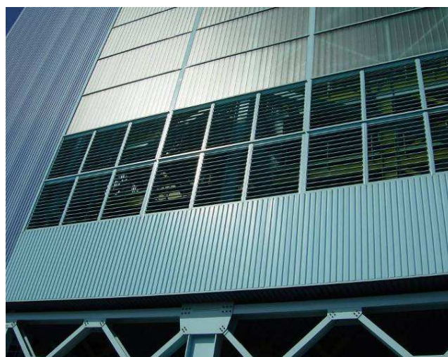
Czerpnia ścienna w Thyssen Krupp – Bonazinc 3000
