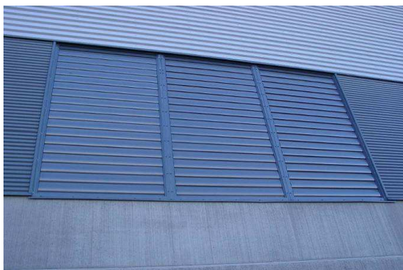
Czerpnia ścienna w Kraftwerk Bitterfeld
